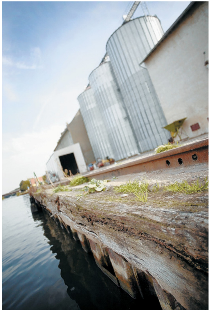
Gefährliche Lage: Weil über viele Jahre keinerlei Instandhaltungsarbeiten am Hafen vorgenommen wurden, bröckelt die Kaimauer vor sich hin. An einigen Stellen ist sie bei Belastung sogar einsturzgefährdet. Zudem reicht die Wassertiefe von 2,60 Metern für Binnenschiffe der neuen Generation nicht aus. FOTOS: T. LARKIN
